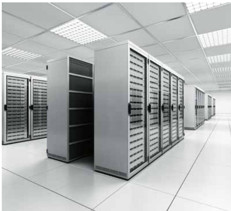
Abbildung 3: Rechenzentrum VBS/Bund 2020, Informatik-Architektur und Infrastruktur
